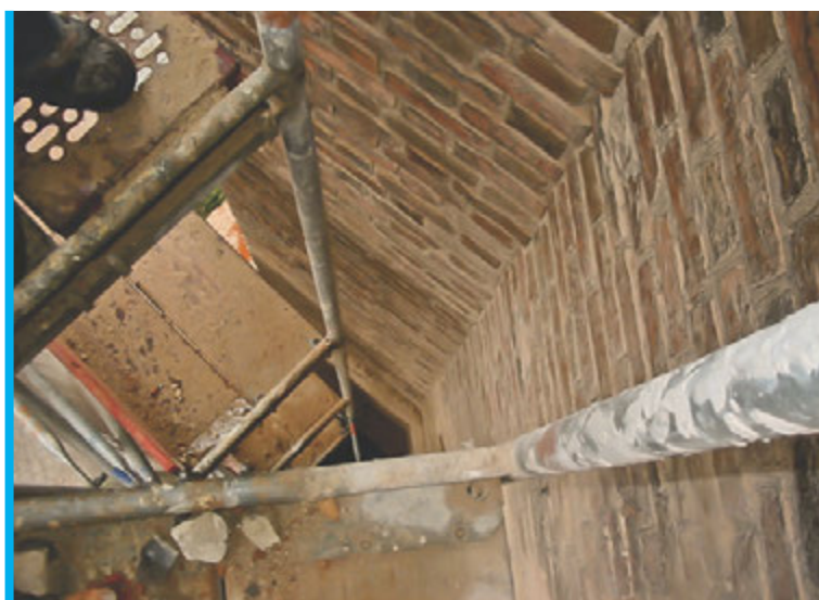
Fot. 7. Przykład pomostu roboczego niepełniającego wymogów bezpieczeństwa.
