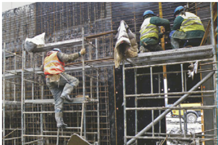
Fot. 8. Przykład stosowania złych praktyk, dotyczących komunikacji na rusztowaniu: komunikacja po ramach rusztowania.
